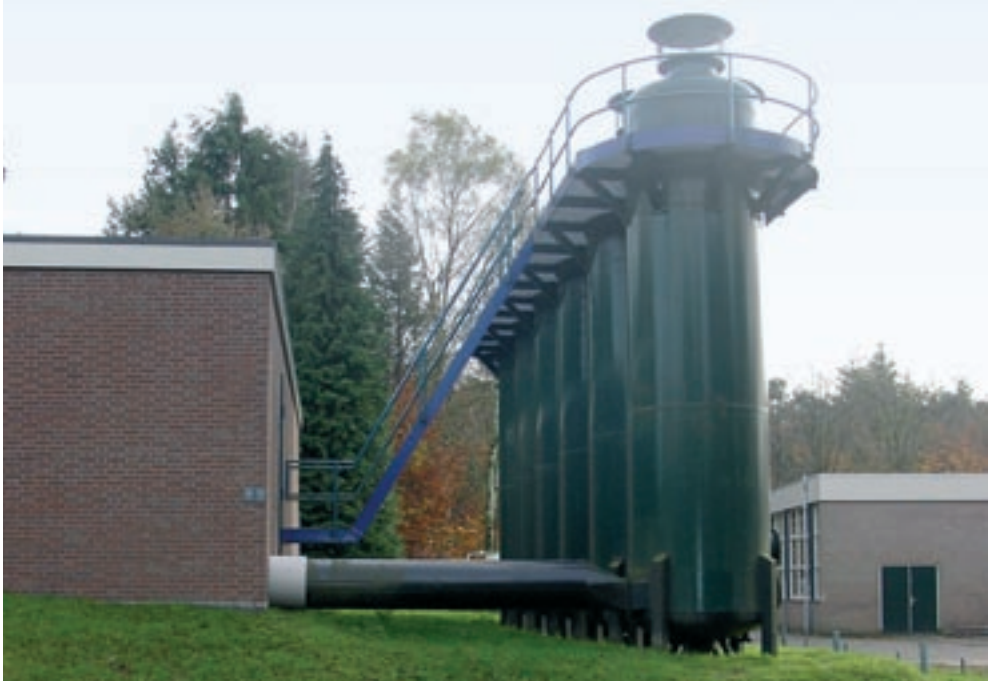
Airstripper bij Gasselte. Restanten bestrijdingsmiddelen worden met behulp van de airstripper uit het water geblazen.
