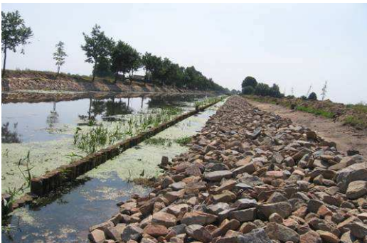
Een flora en fauna vriendelijke oeverconstructie in het buitengebied, een rij palen met een steen bestorting.
