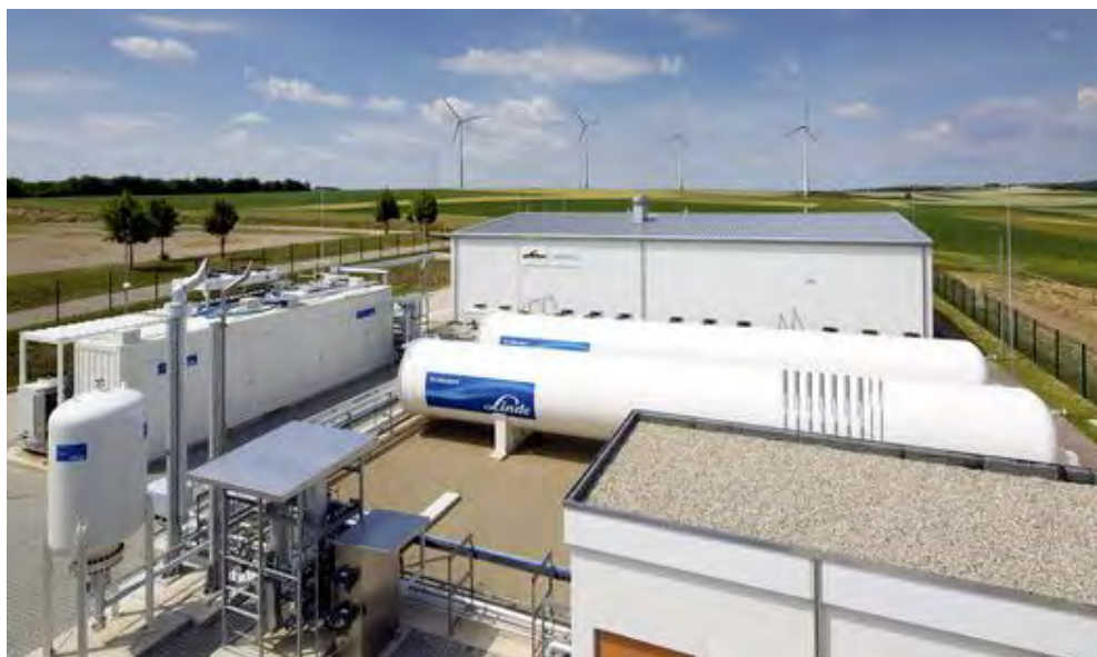
Abb. 4-3: Power to Gas (P2G/PTG) Anlage des „Energiepark Mainz“ 87
