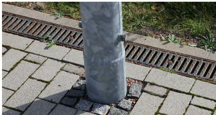
Abb. 3-1 nicht mit der Rückleitung verbundener Beleuchtungsmast, Anschlüsse Schraubverbindungen zur Nachrüstung erkennbar (Foto: Wittemann)
