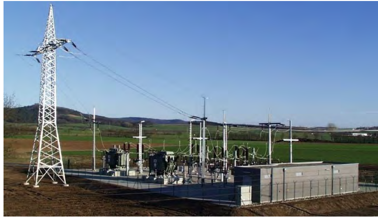
Abb. 3-8 Beispielhafte Abbildung Bahn-Unterwerk der DB Energie (Foto: DB Netz)
