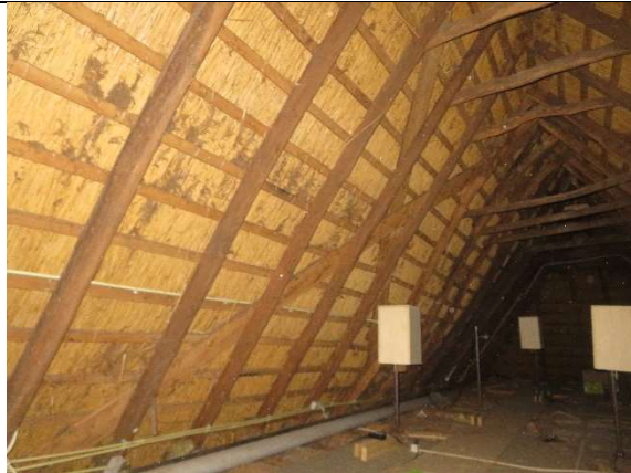
afbeelding 42: Situatie aan de binnenzijde. Hier was het rietpakket aan de binnenzijde nog wel droog.
