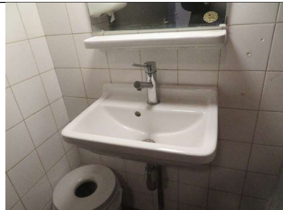
afbeelding 94: Sanitair in toiletruimte voorzijde.
