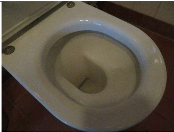
afbeelding 97: Sanitair in toiletruimte voorzijde (geen water in de closetpot)
