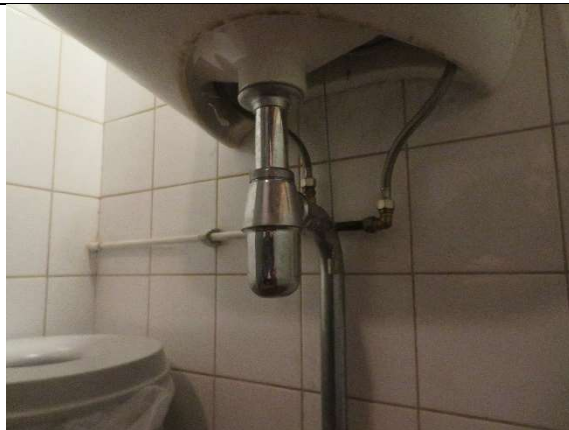
afbeelding 95: Sanitair in toiletruimte voorzijde.
