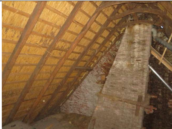
afbeelding 12: Situatie aan de binnenzijde van de achtergevel. Foto genomen vanaf de zolderverdieping.
