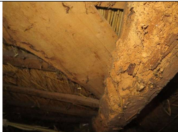
afbeelding 86: situatie linker dakschild. Houtwerk verregaand aangetast. Herstel noodzakelijk.
