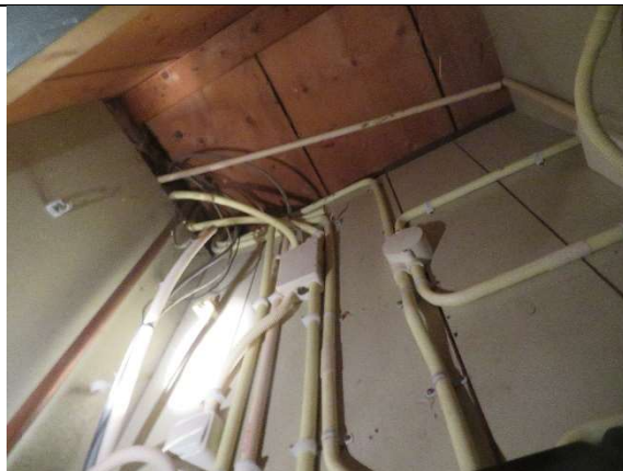
afbeelding 108: Situatie in meterkast. Foto richting zolderverdieping.
