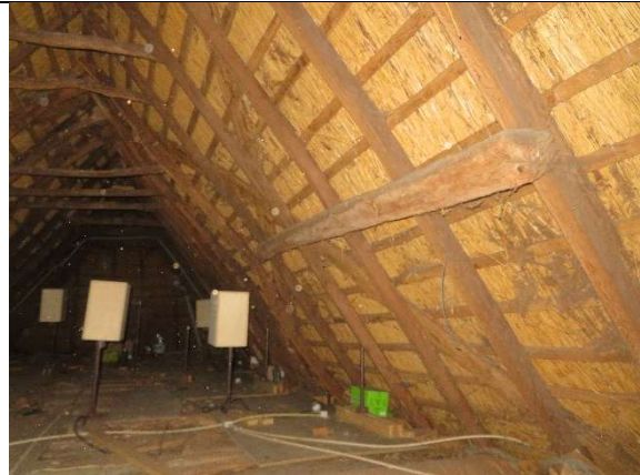
afbeelding 43: Situatie aan de binnenzijde. Hier was het rietpakket aan de binnenzijde nog wel droog.
