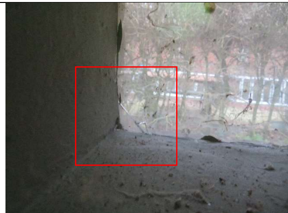
afbeelding 23: Breuk in enkele beglazing.
