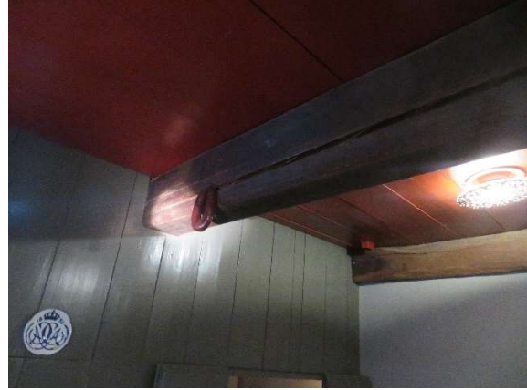
afbeelding 69: Droogtescheuren in balklaag zolderverdieping. Foto genomen vanaf begane grond (achterhuis).
