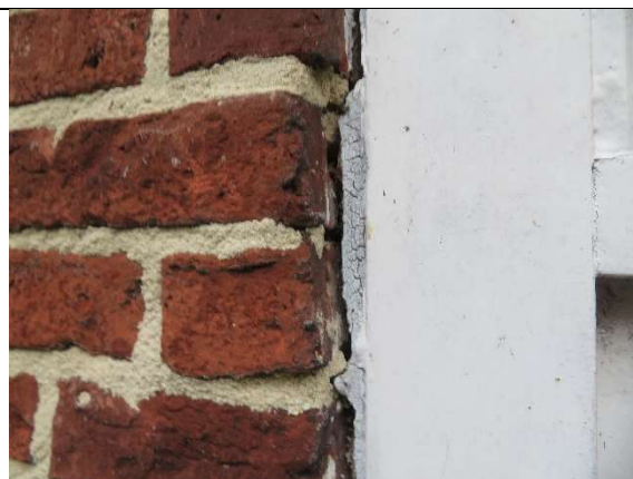
afbeelding 19: Close-Up rode kader afbeelding 18. Aansluiting tussen raamkozijn en gevelmetselwerk is volledig uitgehard en gescheurd.
