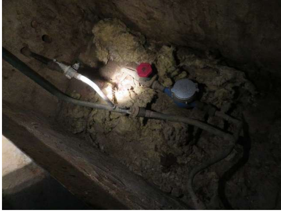
afbeelding 58: Situatie in watermeterput
