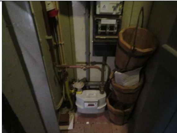
afbeelding 106: Gasinstallatie ter plaatse van de meterkast.
