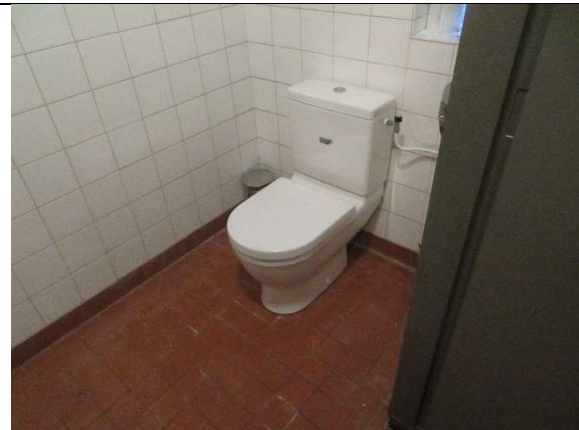
afbeelding 96: Sanitair in toiletruimte voorzijde.
