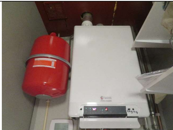
afbeelding 111: cv-ketel met expansievat
