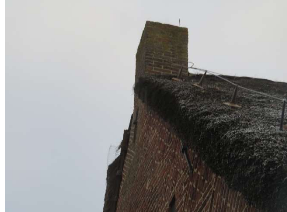
afbeelding 11: De topgevel en de gemetselde schoorsteen trekken naar binnen. De schoorsteen staat scheef.
